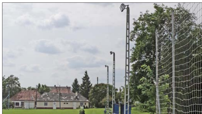
A TAO és az önkormányzat segítségével alakítottuk ki idén a focipályán a világítást
